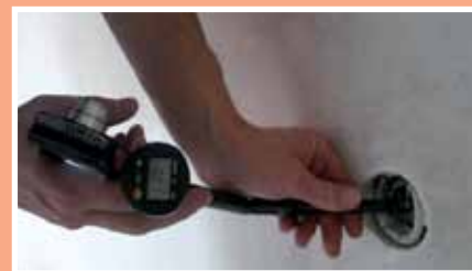
řádně zasádrovaná elektroinstalační krabice je vzduchotěsná
